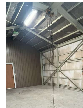
2階手動クレーン
