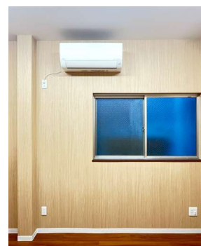
2階洋室エアコン
