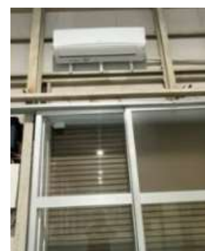
1階入口側エアコン
