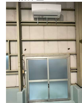
1階裏口側エアコン
