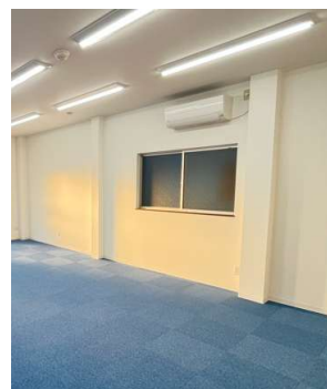
2階事務所エアコン
